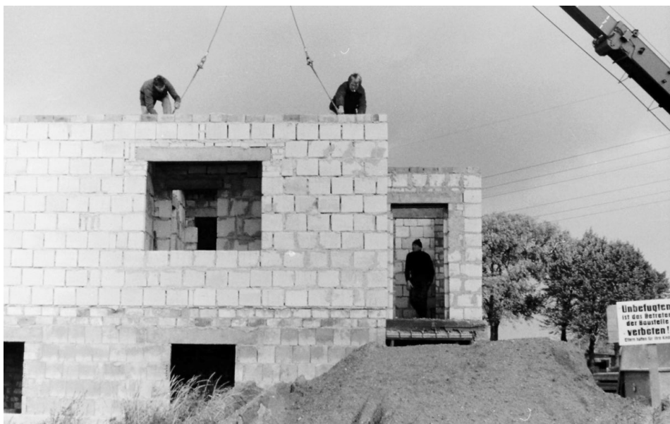
Aufsetzen der Deckenplatten des Erdgeschosses mit einem Kran „ADK-125“ des KRR-18 beim Bau unseres Hauses 1989 (LS)
